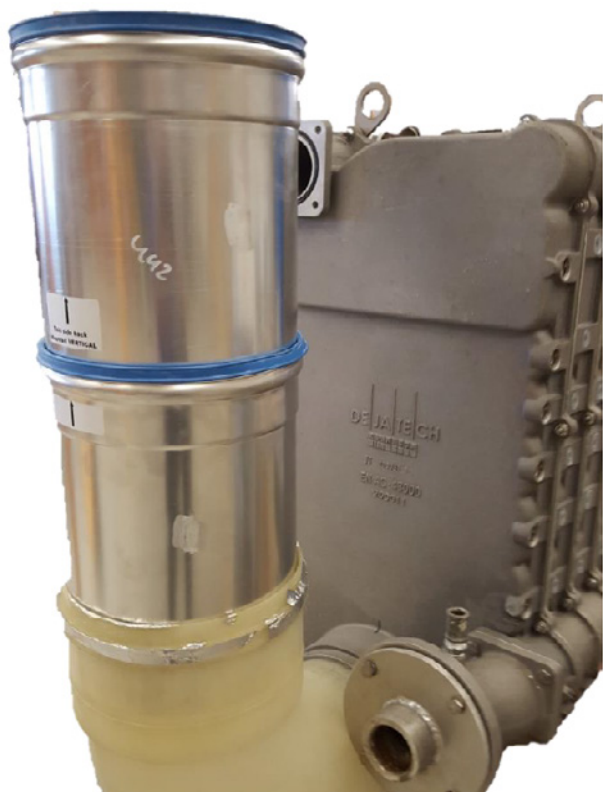
Două amortizoare montate pe un cazan cu 5 secțiuni (340 kW)
